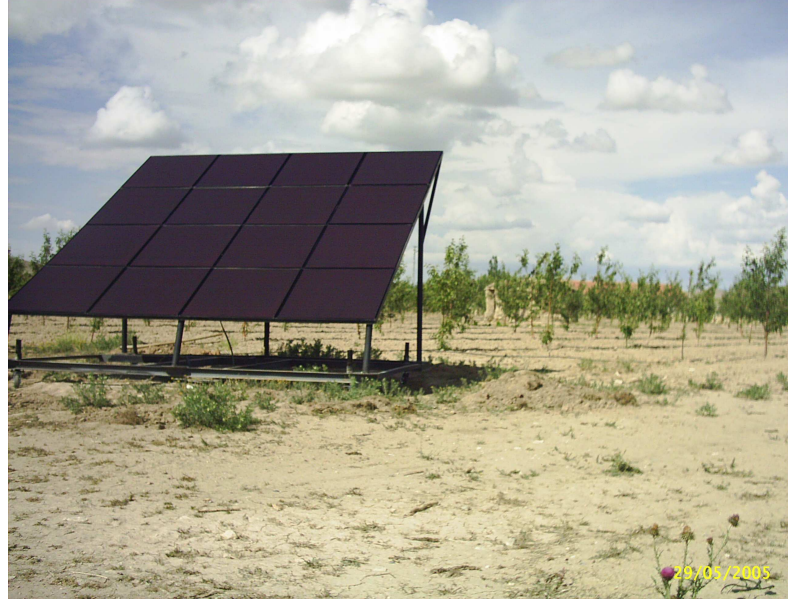
Konya – Fotovoltaik Tarımsal Sulama Sistemi 1.024 Kwp
